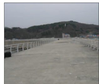
울진 방파제 안전난간
